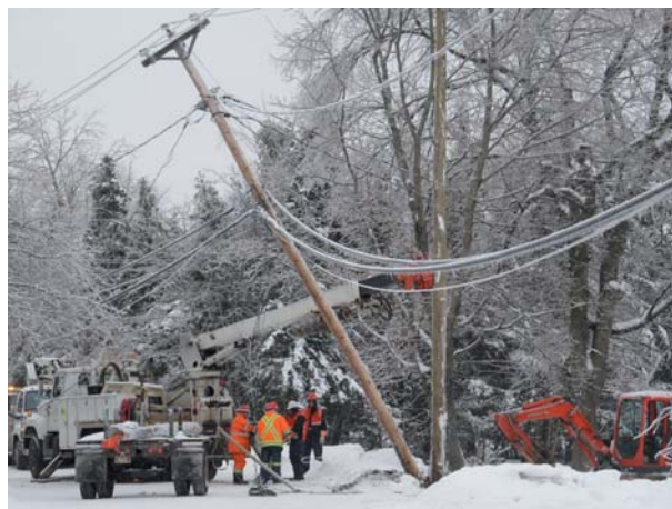
Elektrizitätsnetz-Betreiber bewältigen Auswirkungen eines Sturms. Electricity transmission grid operator responding to impacts of a storm.
